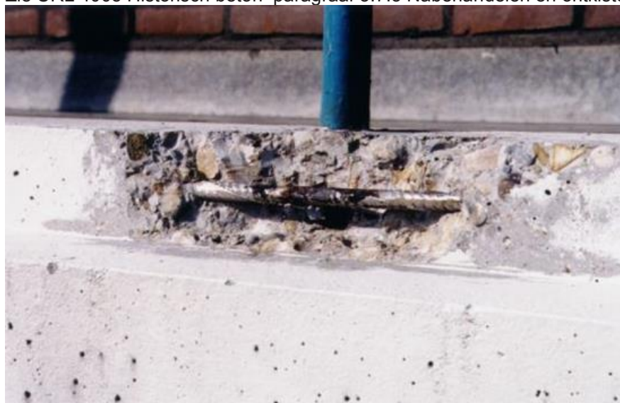
Constructieve schade in een betonnen ondergrond.
