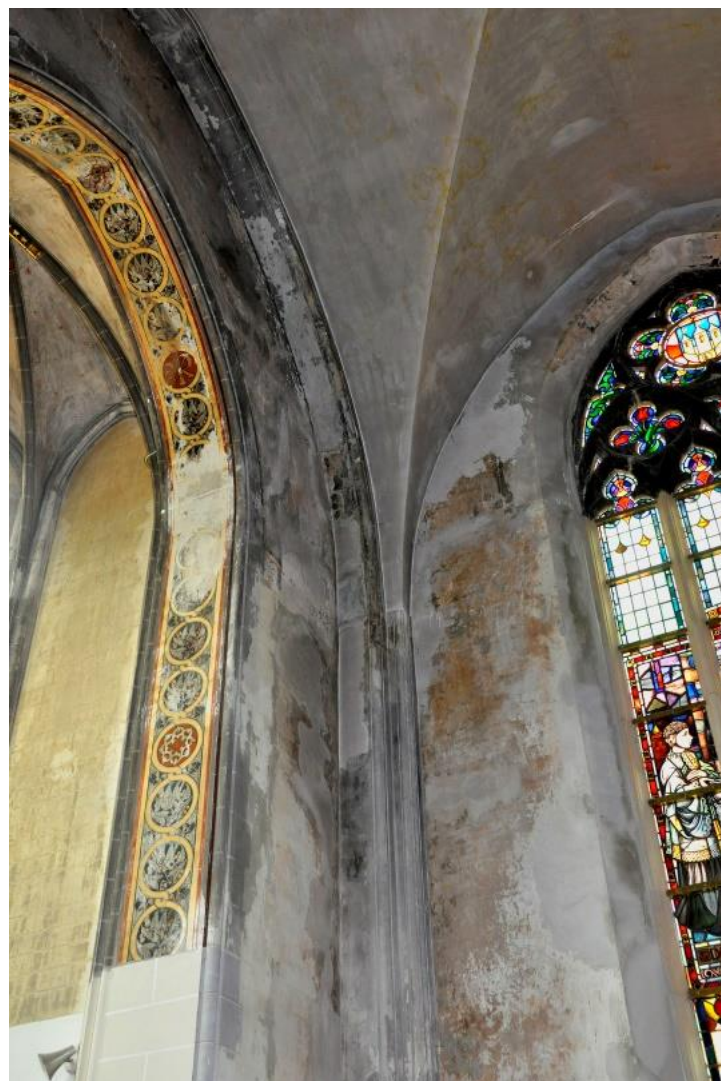
Voorbeeld van een gecompliceerde beginsituatie voor het herstel van Historisch schilderwerk.
