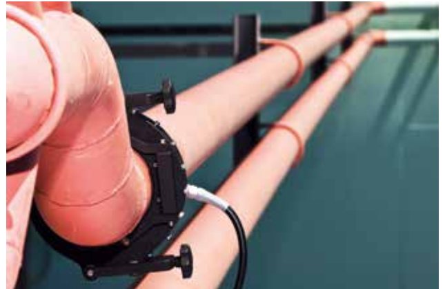
Guided Waven avulla putkistojen tarkastus- ja korjaustoimenpiteet saadaan kohdistettua oikeille alueille.
