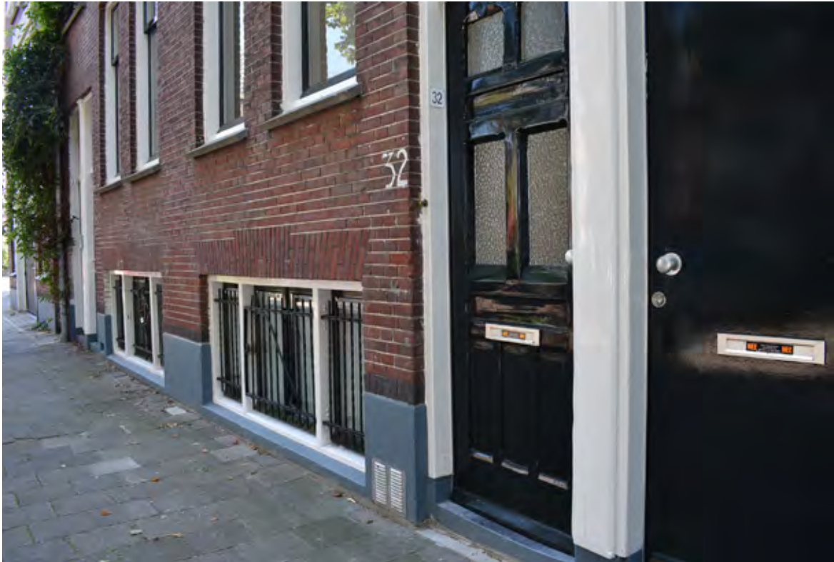
Ramen van een souterrain geven toegang tot de woning en dienen inbraakwerend te zijn.
